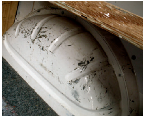
Nutzungsbedingter Abrieb und Kratzer
